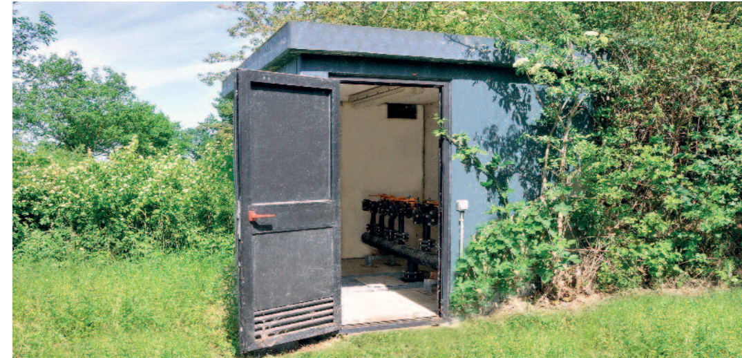
Container mit Deponiegassammelleitungen
